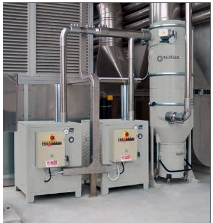
Zentrale Absauganlage in der chemischen Industrie: 2 Saugereinheiten, 1 Filtersilo
